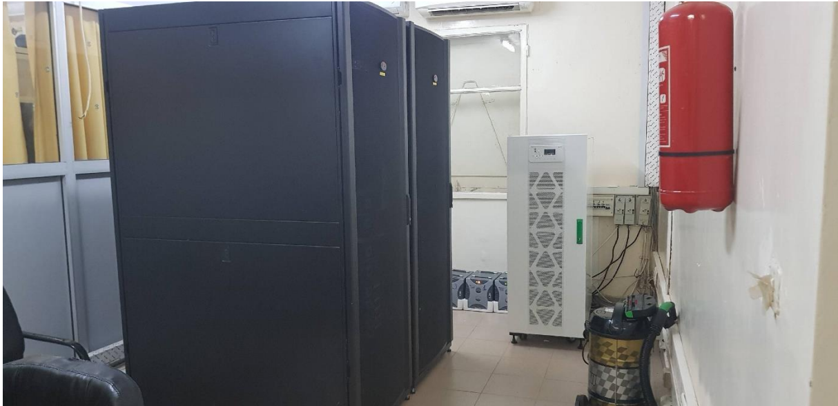
Figure 1 : Système de calcul haute performance installé à l'ACMAD avec 344 cœurs et 600 téraoctets de capacité de stockage.
